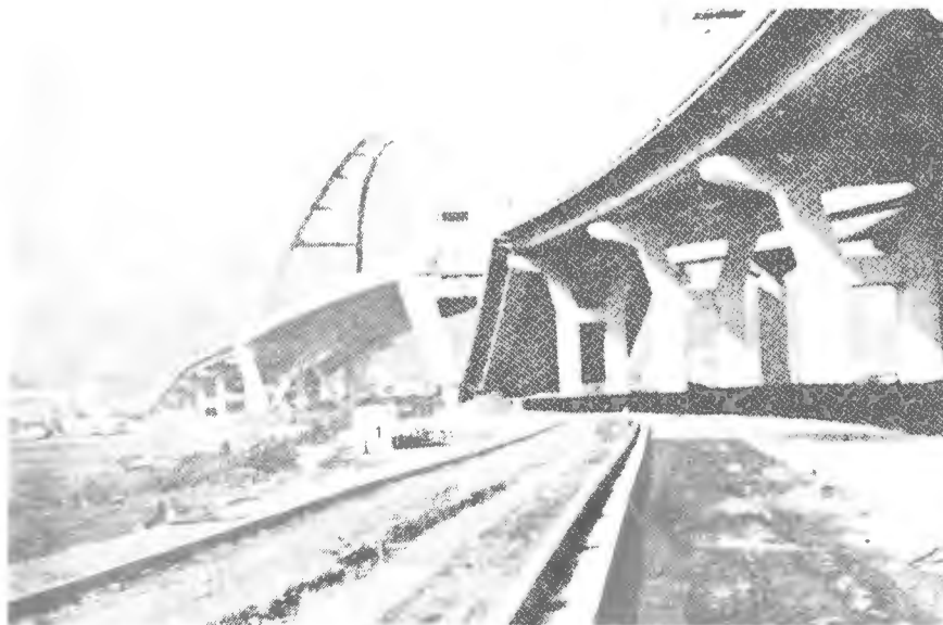
شکل ۸ - فرو ریزی یکی از دهانه‌های ورودی پل نیشی‌نومیا - کو
