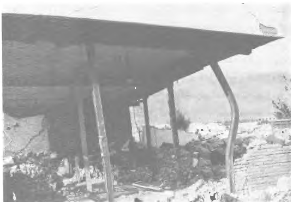
شکل ۵- ساختمان اسکلت فلزی در شهر منجیل نمونه‌ای از رفتار ساختمان‌های مشابه را ارائه می‌دهد.
