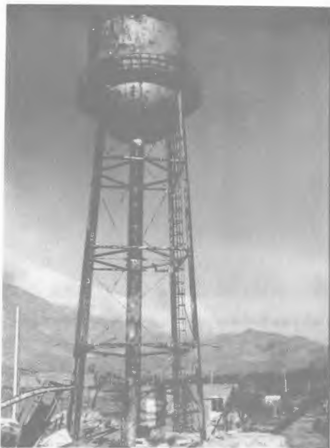
تصویر ۱۰- رفتار مناسب یک برج فولادی آب در منطقه زلزله زده. فقط مهاربندی‌های متشکل از میلگرد و بست دویچه بریده شده‌اند
