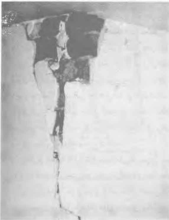
تصویر شماره ۱۷- آسیب دیدن گوشه آزاد دیوار در مهمانسرای سیمان خزر
