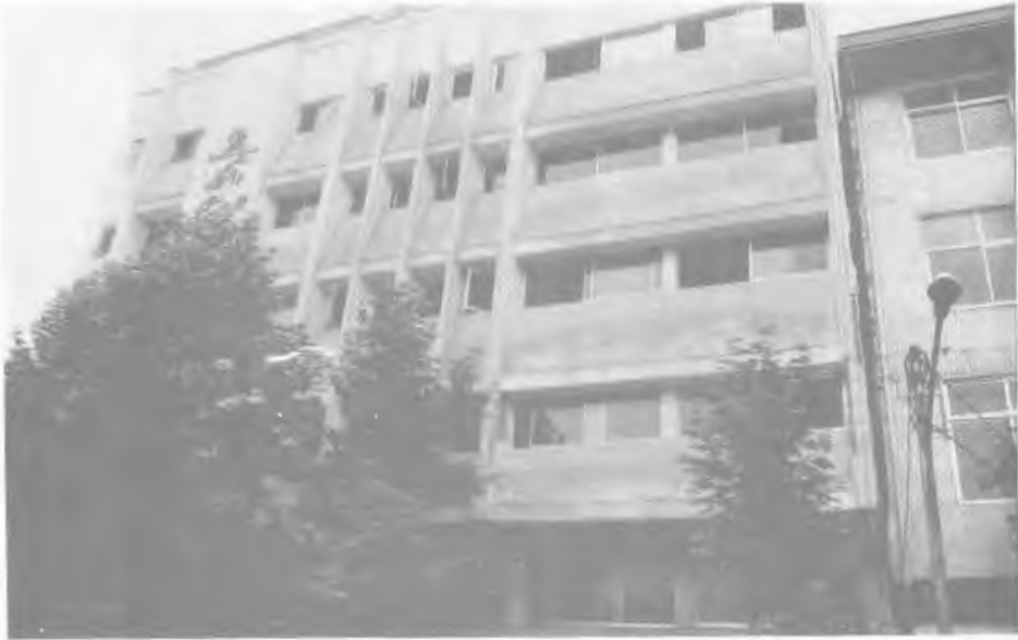
شکل ۱۲- ضربه زدن ساختمان‌های مجاور، تغییر شکل‌های ضیاع تجاهی و چرخش اتصالات ساختمان بلندتر موجب باز شدن درز بین دو ساختمان گردیده است.
