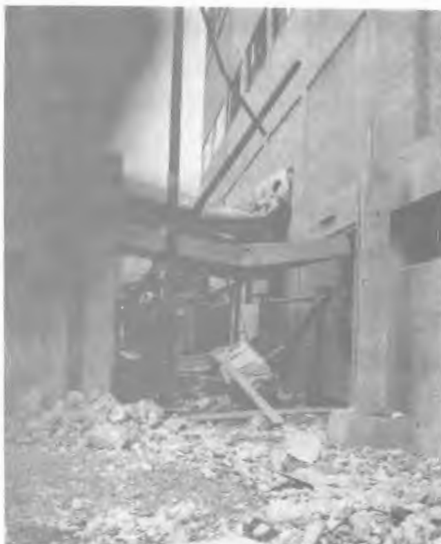
تصویر ۵ - سقوط قطعات الحاقی بتن مسلح گسیخته شده بر روی شریان اصلی نیروگاه و تخریب آن
