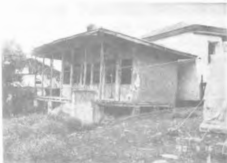
شکل ۱۴ - نشست یک خانه روستایی در منطقه آبگونه شده شمال شرق آستانه
