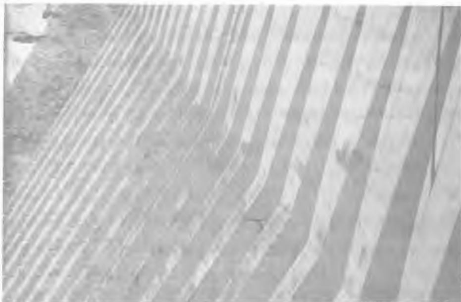
تصویر ۷- نشت آب از ترک‌های ایجاد شده در بدنه سد سفیدرود (منجیل)
