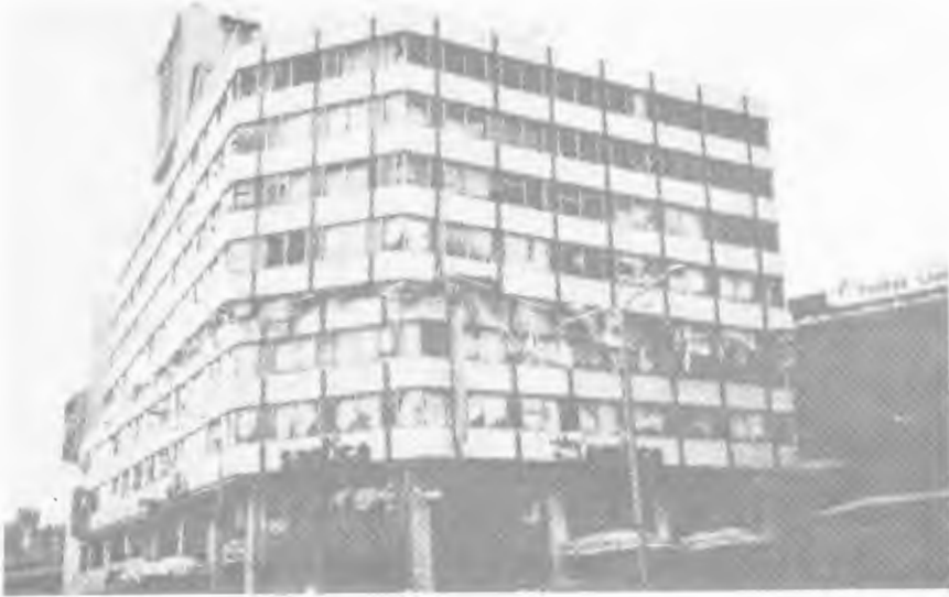
عکس شماره ۴- خرابی در طبقه نرم میانی
