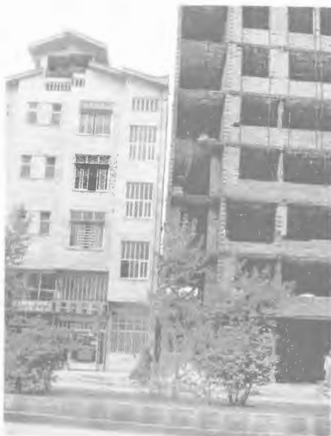
شکل ۱۳- ساختمان نیمه تمام بنیاد مسکن انقلاب اسلامی رشت در ۸ طبقه و ساختمان ۵ طبقه مجاور آن
