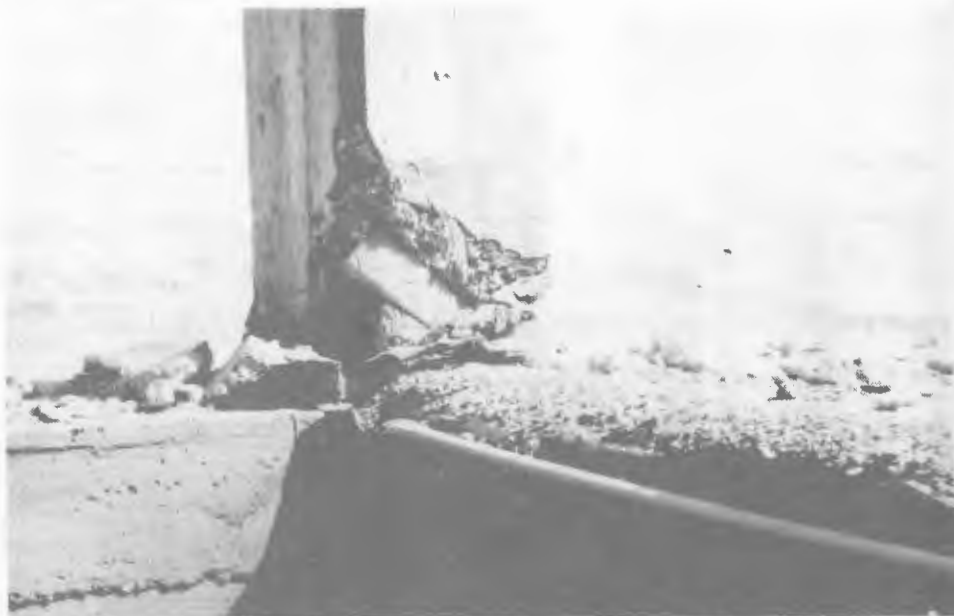
تصویر شماره ۶- گره تحتانی ستون کناری راه پله - قطعه چوب در سطح واریز دیده می شود
