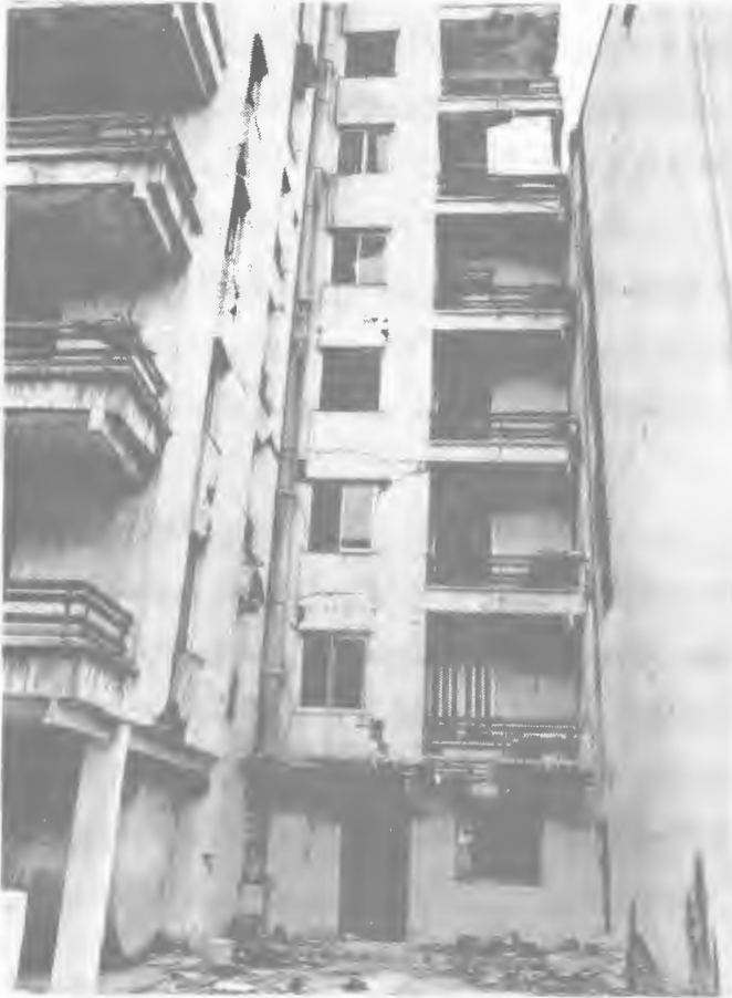
شکل ۱۰ - ساختمان‌های اسکلت فلزی در میدان گاز که به علت چرخش ستون‌ها و اتصالات در طبقات پایین از شاقول خارج شده‌اند.
