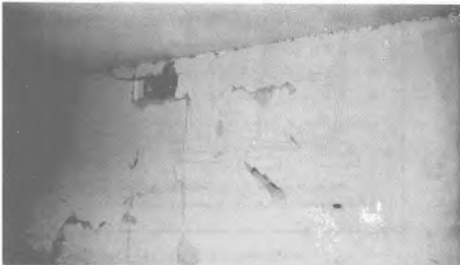
تصویر شماره ۱۹- ترک خوردن دیوار و آغاز خورد شدن آن در گوشه قاب در مهمانسرای سیمان خزر
