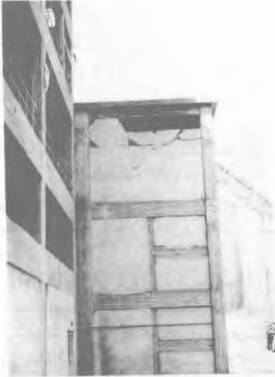
تصویر شماره ۲۲- آسیب دیدن دیوار ساختمان انبار پاکت کارخانه سیمان خزر
