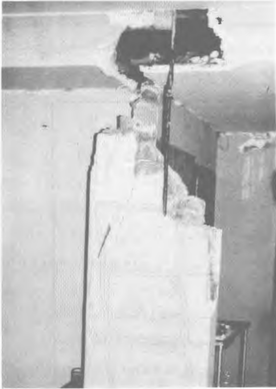
تصویر شماره ۱۸- آسیب دیدن تیغه‌ها در مهمانسرای سیمان خزر
