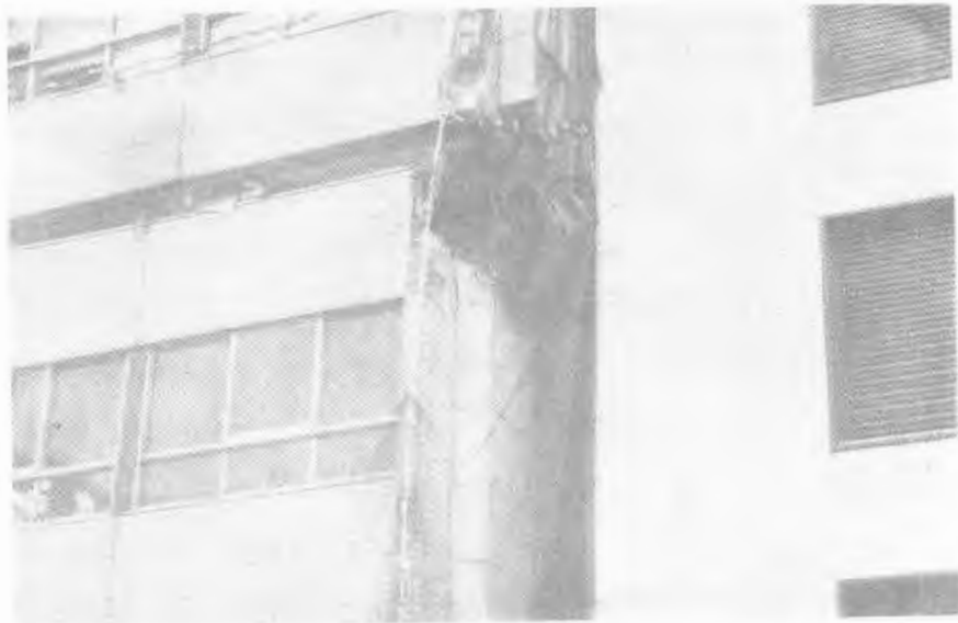
عکس شماره ۶- خرابی در طبقه نرم میانی
