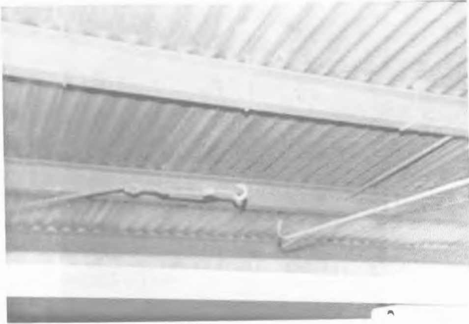
شکل ۱۴- داخل یک ساختمان صنعتی که مهاربندی‌های سقفی آن بر اثر زلزله گسیخته شده‌اند.
