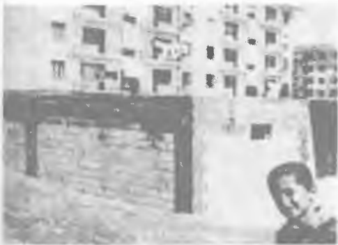
تصویر ۸ - دیوار زیر زمین در آپارتمان نوساز
