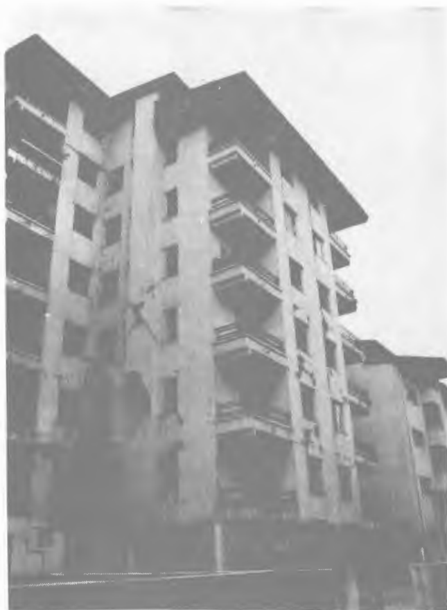
شکل ۱۱- ساختمان‌های مسکونی ۷ طبقه در میدان گاز. تمرکز خرابی‌ها در طبقات پایین‌تر به چشم می‌خورد.
